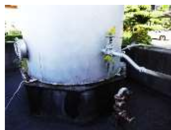
20000k 重油タンク
